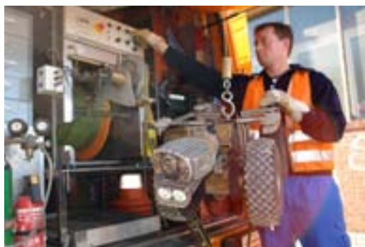
Kamera für die Überprüfung der Abflusskanäle
