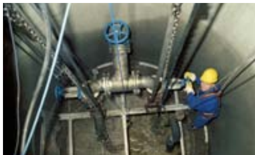
Blick in eine Pumpstation
